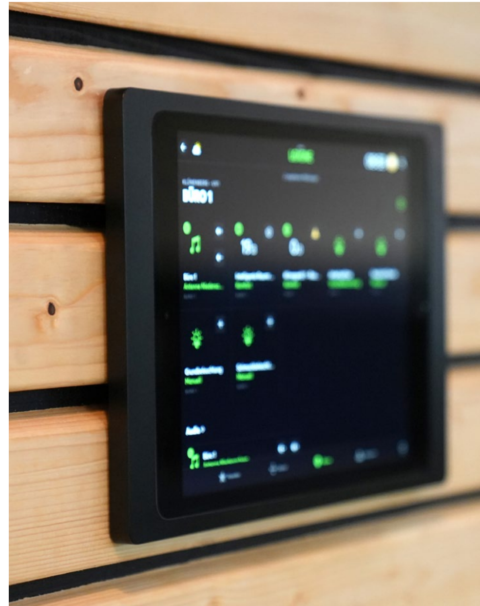
Loxone. Unsere Smart Offices lassen sich dank Loxone automatisieren und steuern.
